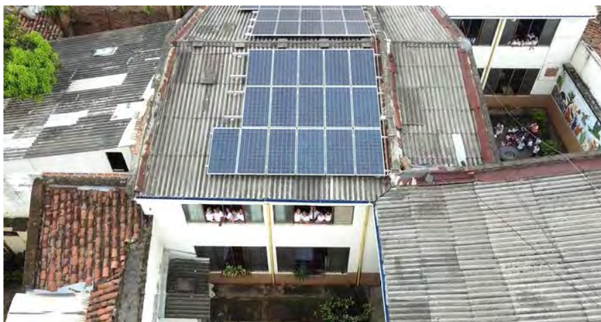
Panneaux solaires sur le toit de l'éco-école Carlos A. Sardi (Ville de Cali, https://www.cali.gov.co/dagma/publicaciones/172642/cali-cuenta-con-la-primerae-co-escuela-para-combatir-el-cambio-climatico/ ).
